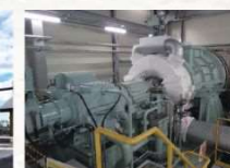
タービン・発電機
