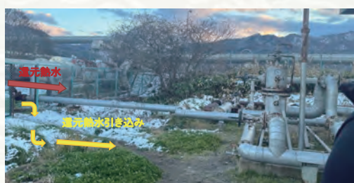
還元熱水の一部を熱交換器に引き込む配管
