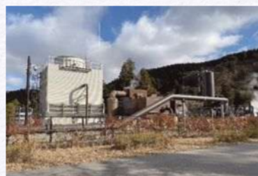
南阿蘇湯の谷地熱発電所の外観
